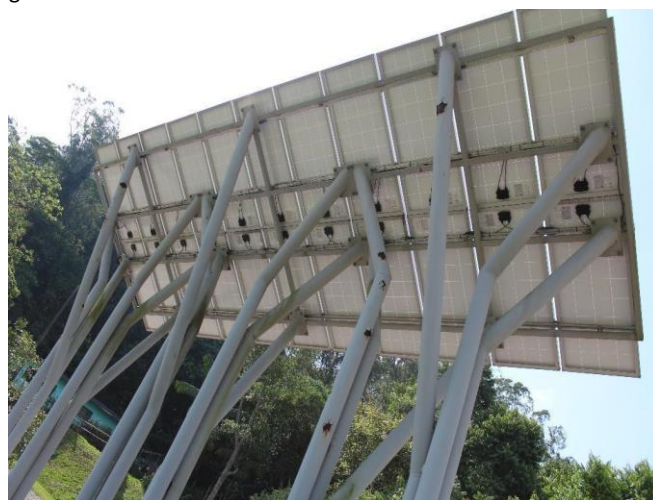
Figura 8 - Parte Inferior da infraestrutura do sistema solar fotovoltaico
