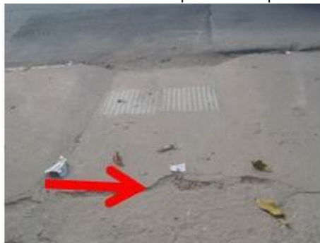
Figura 03 - Rebaixo do meio fio em frente ao prédio e em piso danificado na calçada.
