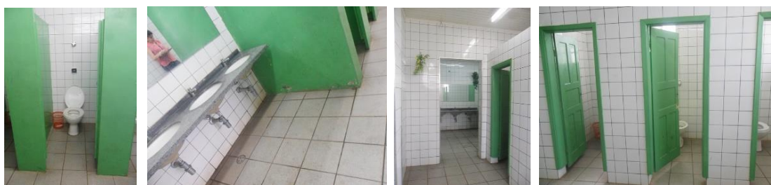
Sanitários sem banheiro adaptado.
