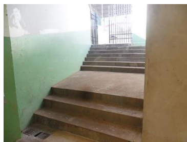
Escadarias para acesso a quadra de esportes, sem rampas.
