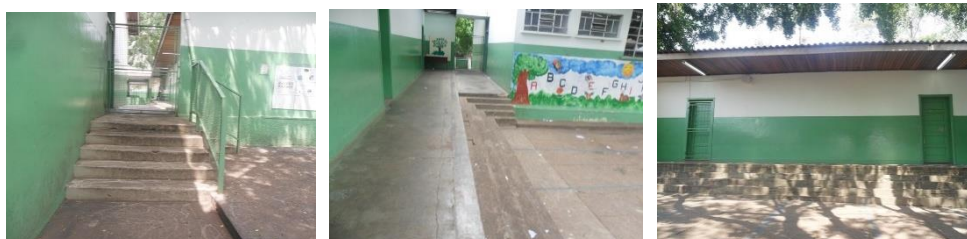
Escadaria para acesso ao pátio descoberto sem rampas.
