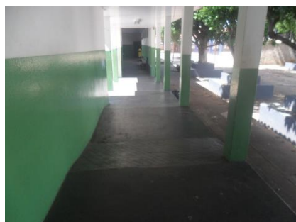
Rampa com inclinação alta.
