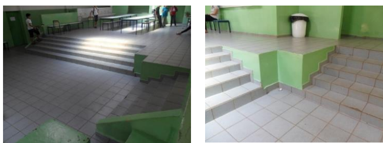
Escadaria para acesso ao pátio, não há rampas.
