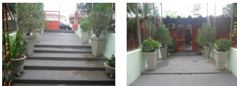
Entrada principal para secretaria, escadaria sem rampa de acesso.
