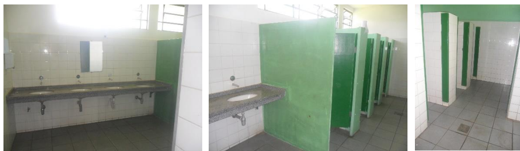
Sanitários sem banheiro adaptado.
