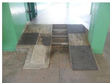
Rampa com inclinação alta.
