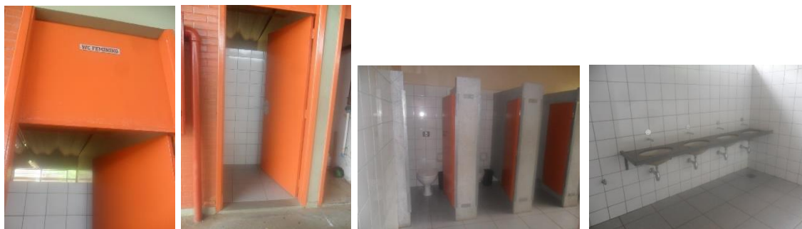
Sanitários sem banheiro adaptado.
