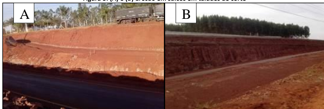
Figura 3: (A) e (B) Erosão em sulcos em taludes de corte
