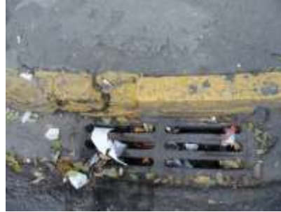
Figura 9: Resíduos na boca de lobo.
