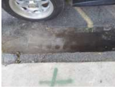
Figura 8: Boca de lobo obstruída.
