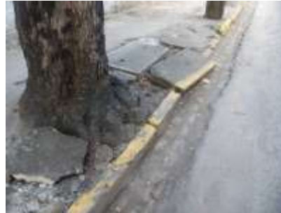
Figura 11: Árvores próximas a bocas de lobo.
