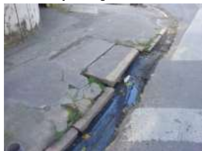
Figura 13: Presença de esgoto na rede de drenagem.
