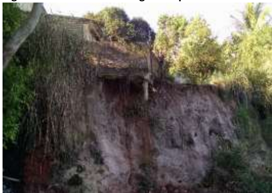
Figura 10a – Erosão na margem esquerda
