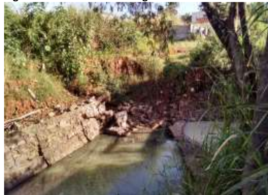
Figura 10b – Erosão na margem direita
