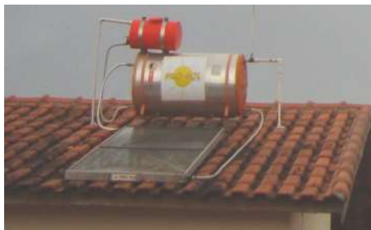
Figura 5: Sistema solar de aquecimento de água da PRO-SOL instalado em residência do Conjunto Nova Tupã (Jamil Dualib).
